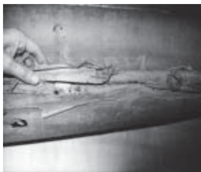
写真4 上部表面の状況
