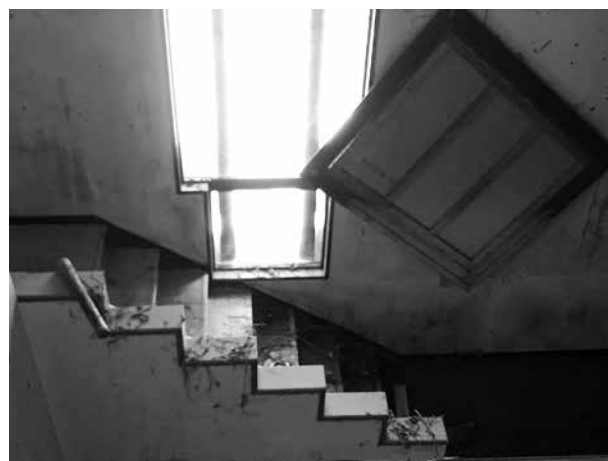
被災状況（2018年7月20日） *倉敷市真備支所提供
